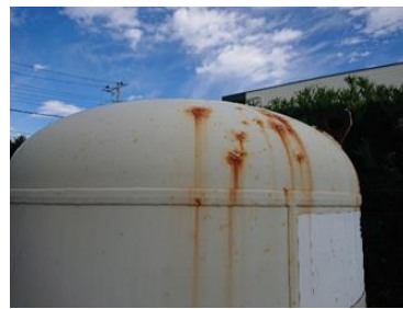
バルク貯槽上部
