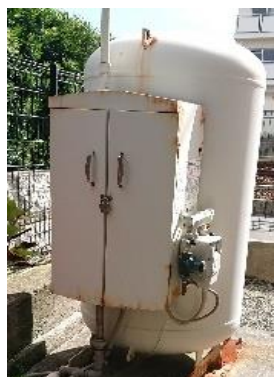
バルク貯槽全体
